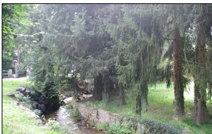
Rive droite : mur instable prêt à basculer, résineux, berge verticale
