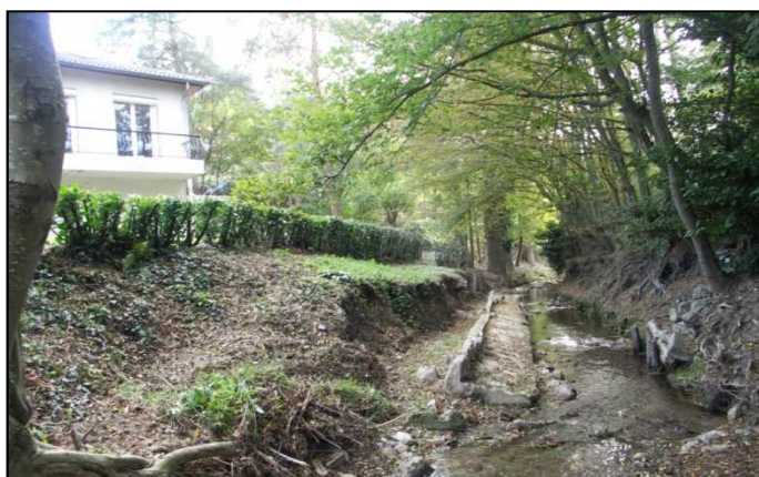
Rive gauche : mur basculé, érosion au droit d'une propriété résidentielle
